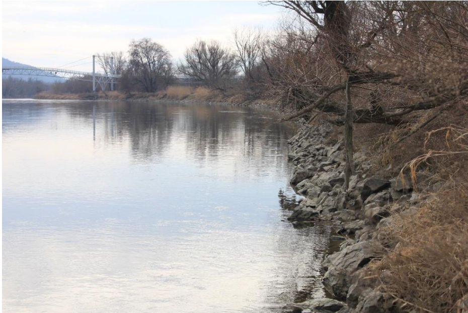
Abbildung 5: Inzwischen sind die Regulierungsbauwerke großteils überwachsen, die Steinschüttung ist in vielen Abschnitten aber noch gut sichtbar © Copyright RIOCOM/Roither
